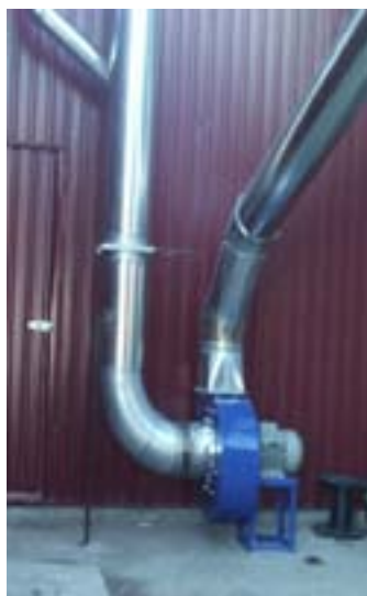
Bilden visar 7,5kW PDB-fläkt ansluten till kanalsystem.
