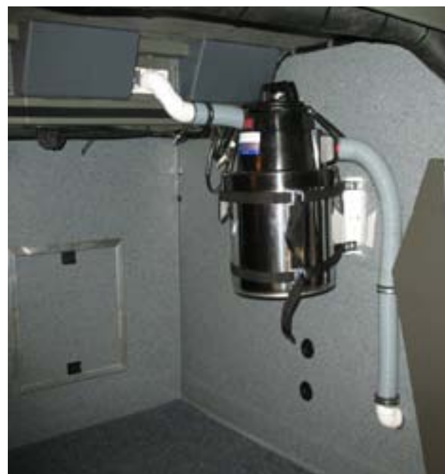
Bilden visar centralenhet med motortopp i plast och 15 liters behållare monterad i bagage utrymmet i en buss.
