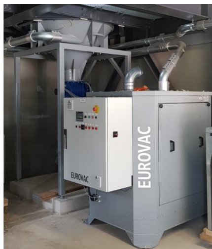
Bilden visar 55kW rootspump i eget bullerhus
