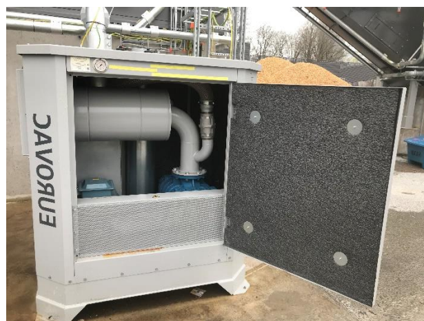
Bilden visar 37kW rootspump i eget bullerhus
