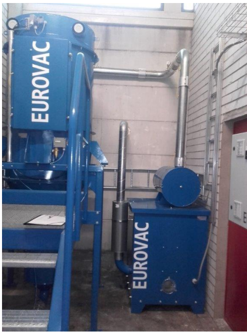
Bilden visar 25kW sidokanalfläkt i eget bullerhus
