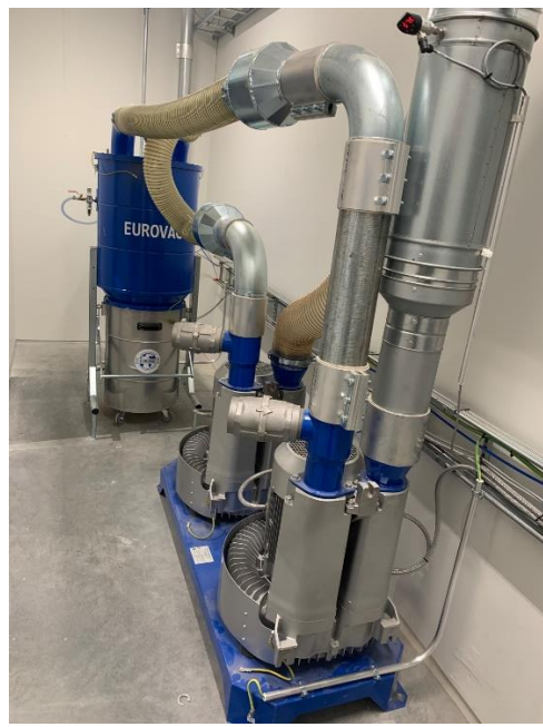
Bilden visar 2st 11kW sidokanalfläktar på eget golvstativ
