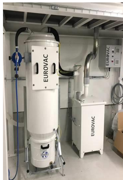
Bilden visar 5,5kW sidokanalfläkt i eget bullerhus
