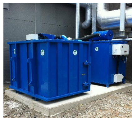
Bilden visar en 3m 3 filtercontainer och 37kW rootskompressor i monterad i bullerhus
