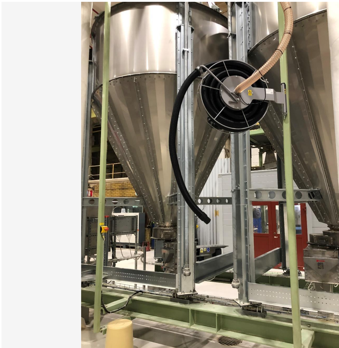
Bilden visar slangupprullare ATEX med 10m, 50mm slang monterad på Stora Enso AB, Circular Solutions
